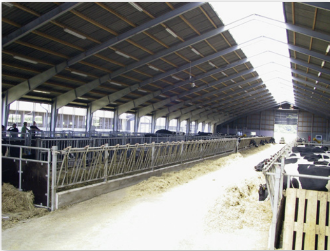
Abbildung 8: Praktisches Beispiel für den Einbau von Leuchtstoffröhren direkt unter Dach
