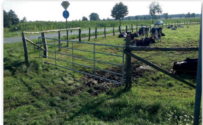
Abbildung 13: Tiefe Fahrspuren unter dem Tor sind eine Schwachstelle (© F. Faß)
