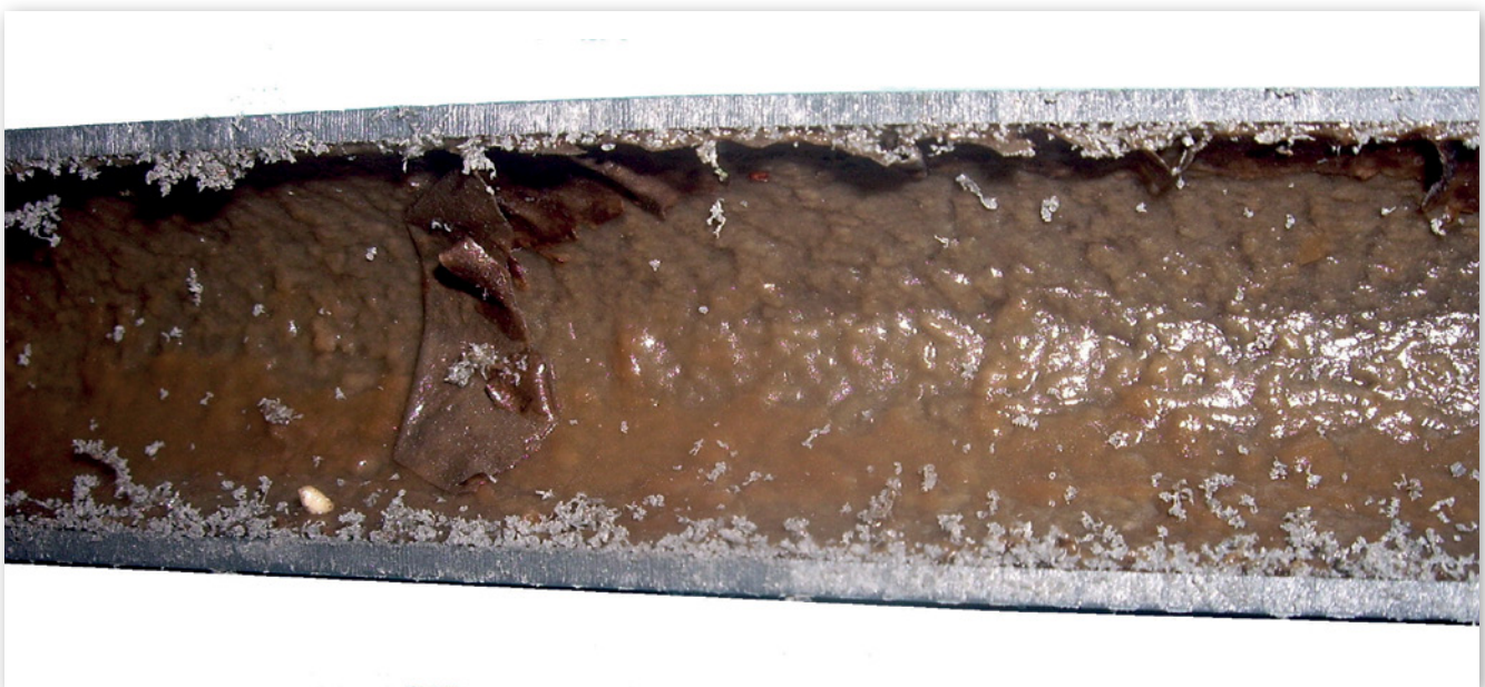
Abbildung 1: Biofilm in Wasserleitungen (Quelle: Aumann Hygienetechnik)
